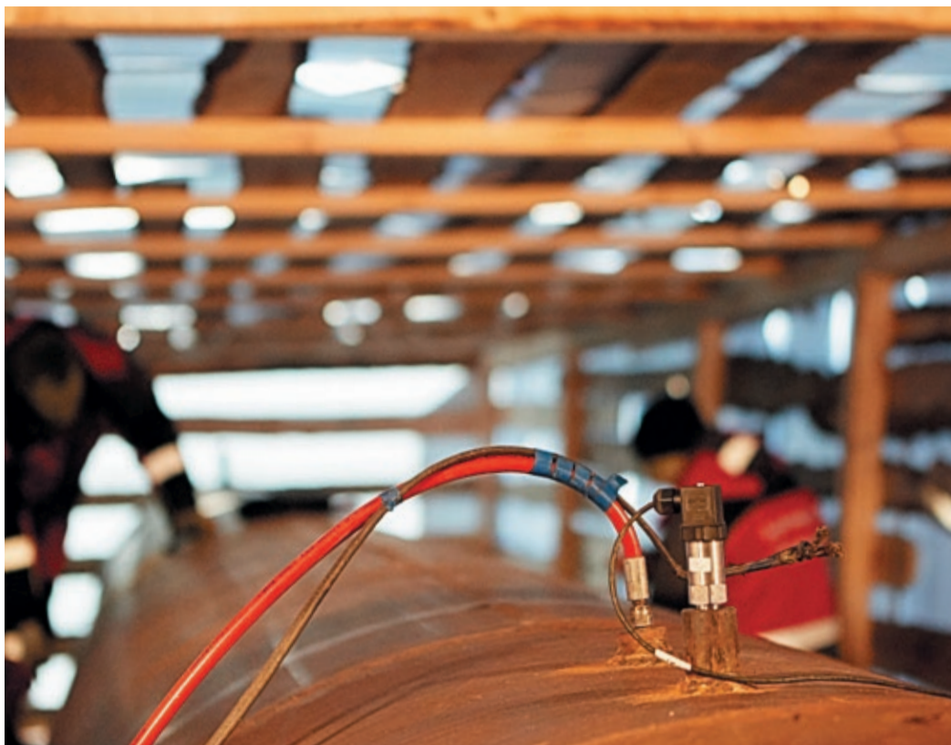
Перед испытаниями в стенки трубы врезают штуцеры для датчиков давления и подачи воды
