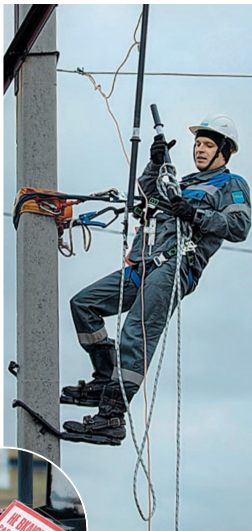
Главное правило электрика: отключи, проверь, заземли
