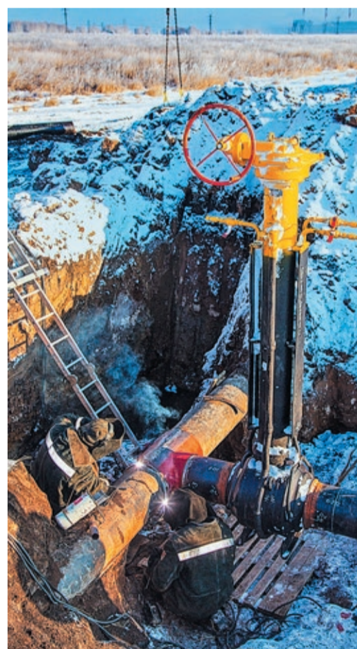
В 2014 г. без остановки транспорта газа подключили ГРС для нового энергоблока Южноуральской ГРЭС
