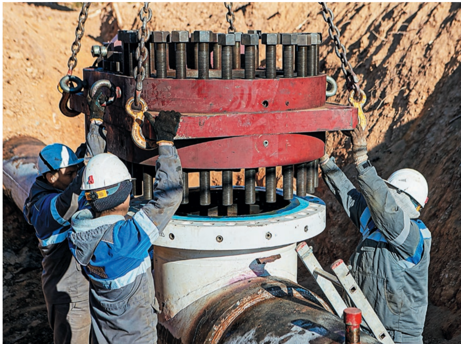
Уральские газовики стали пионерами ПАО «Газпром» в освоении технологии врезки под давлением
