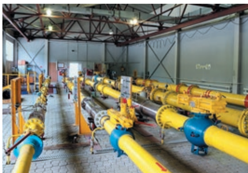
Трубопроводы и эталонные счетчики УРМЦ образуют высокоточный измерительный инструмент
