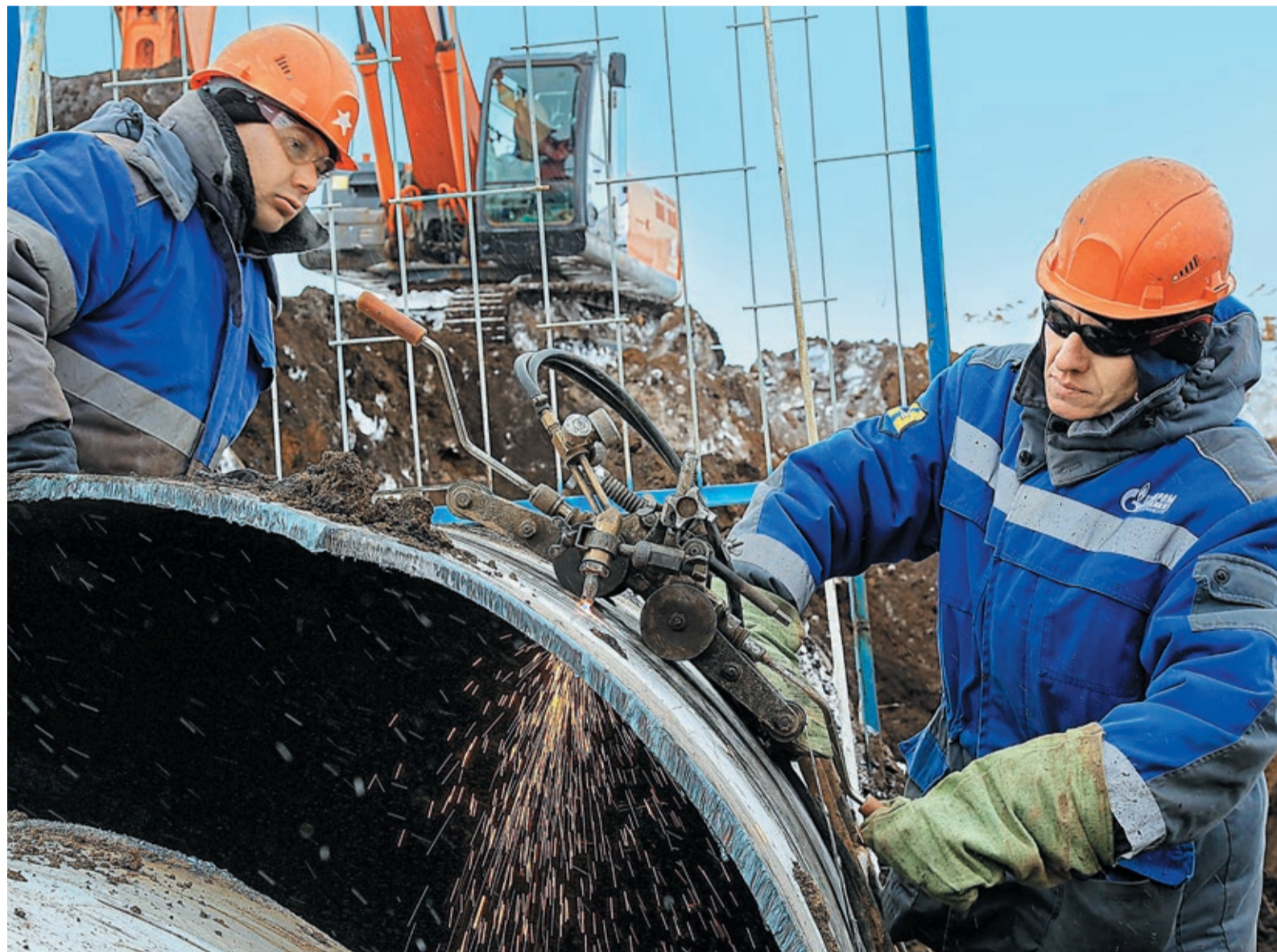
Большая часть дефектов, обнаруженных на воздушных переходах, подлежит вырезке с заменой участка трубы. За работой — газорезчики Александр Петров и Андрей Соловей
