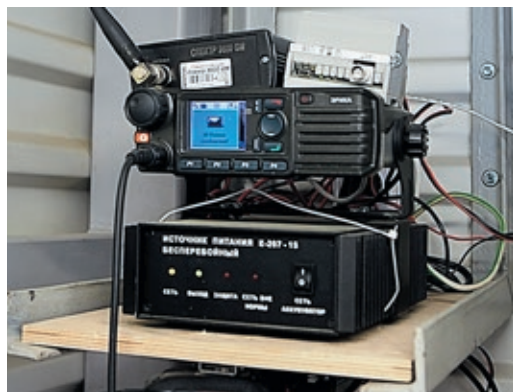
Передача данных на главный щит осуществляется через радиостанцию «Эрика»
