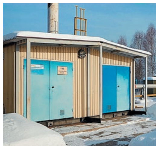
После капитального ремонта в 2006 году ГРС «Никола-Павловское» оснастили системой автоматического управления
