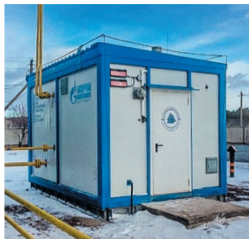
Турбодетандеры общей мощностью 15 кВт, на фото — модульная турбодетандерная установка
