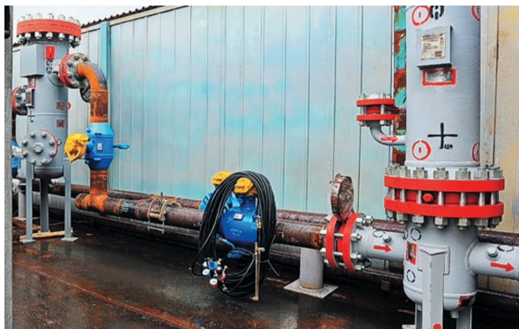
Базовые элементы технологической обвязки — серые колонны нового фильтра-сепаратора (слева) и газодляного теплообменника
