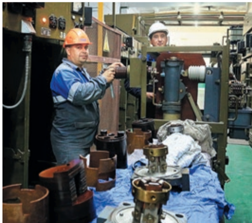
Благодаря грамотному обслуживанию масляные выключатели на КС-17 исправно работают с 1964 года
