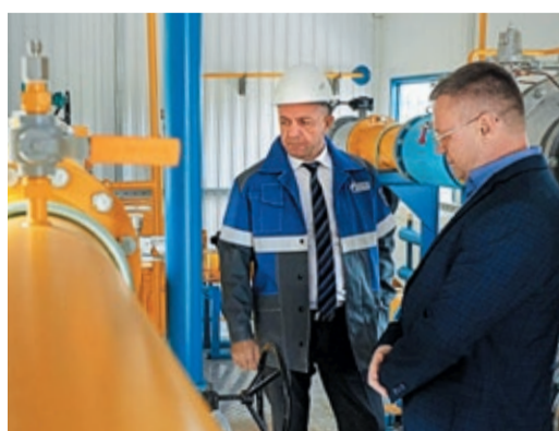
Сергей Трапезников (слева) осмотрел новый пункт редуцирования
