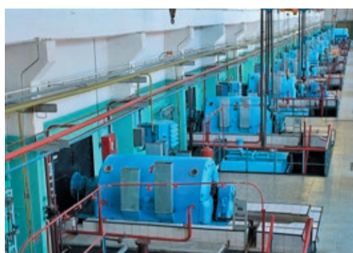
Основная экономия электроэнергии достигнута за счет компрессорных станций с электроприводными ГПА
