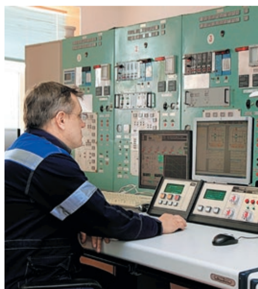
Работу газоперекачивающих агрегатов контролируют на главном щите компрессорной станции
