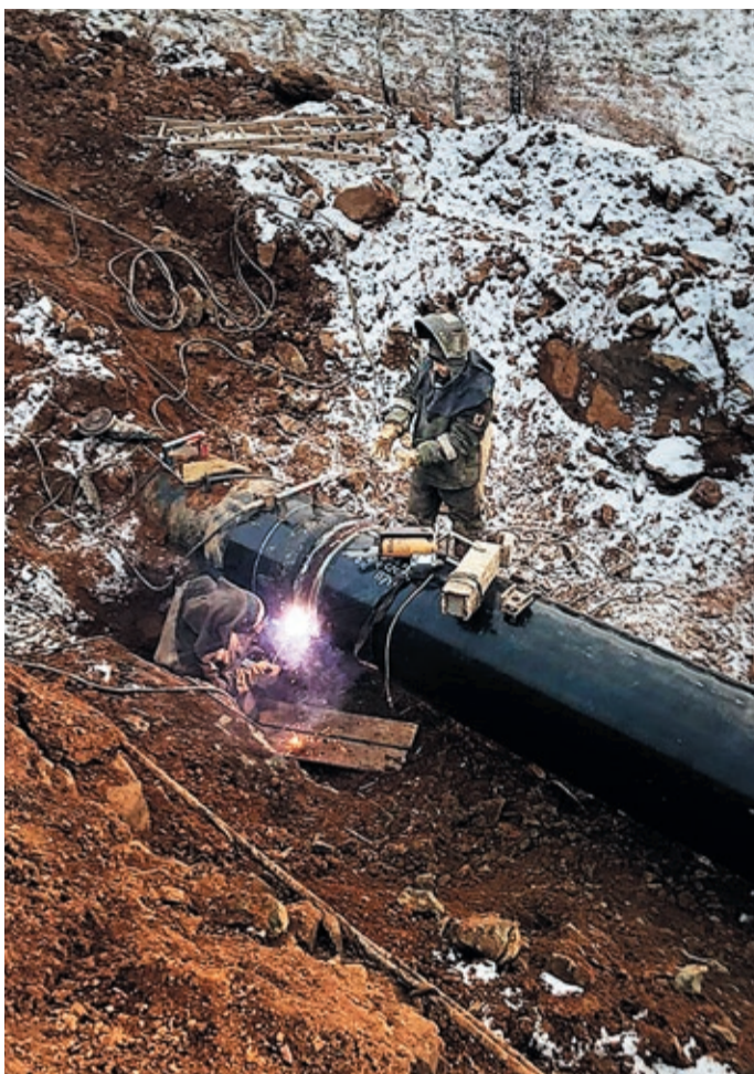
Основной способ борьбы с КРН — замена трубы
