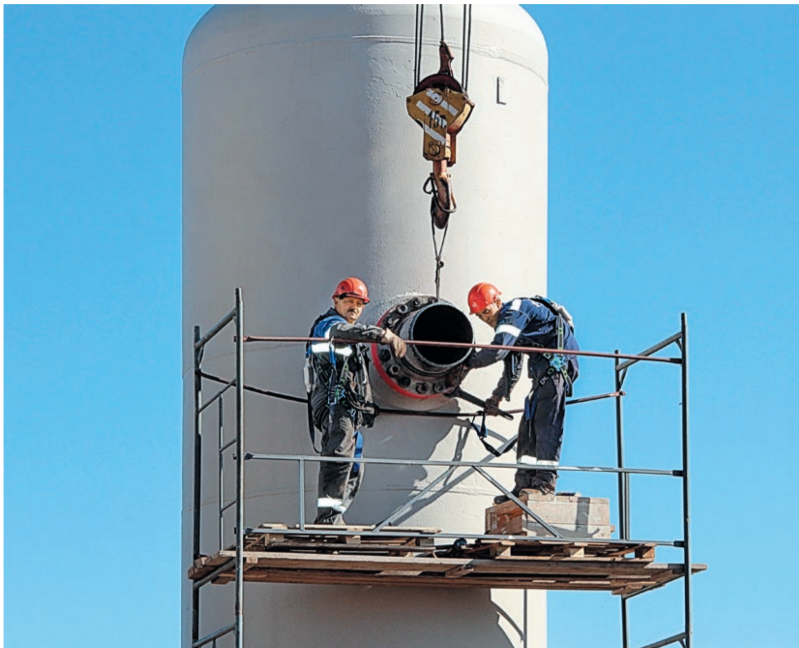
Во время комплексов ППР работы идут в глубокой траншее и на высоте нескольких метров над землей. На фото — компрессорная станция Карталинского ЛПУМГ
