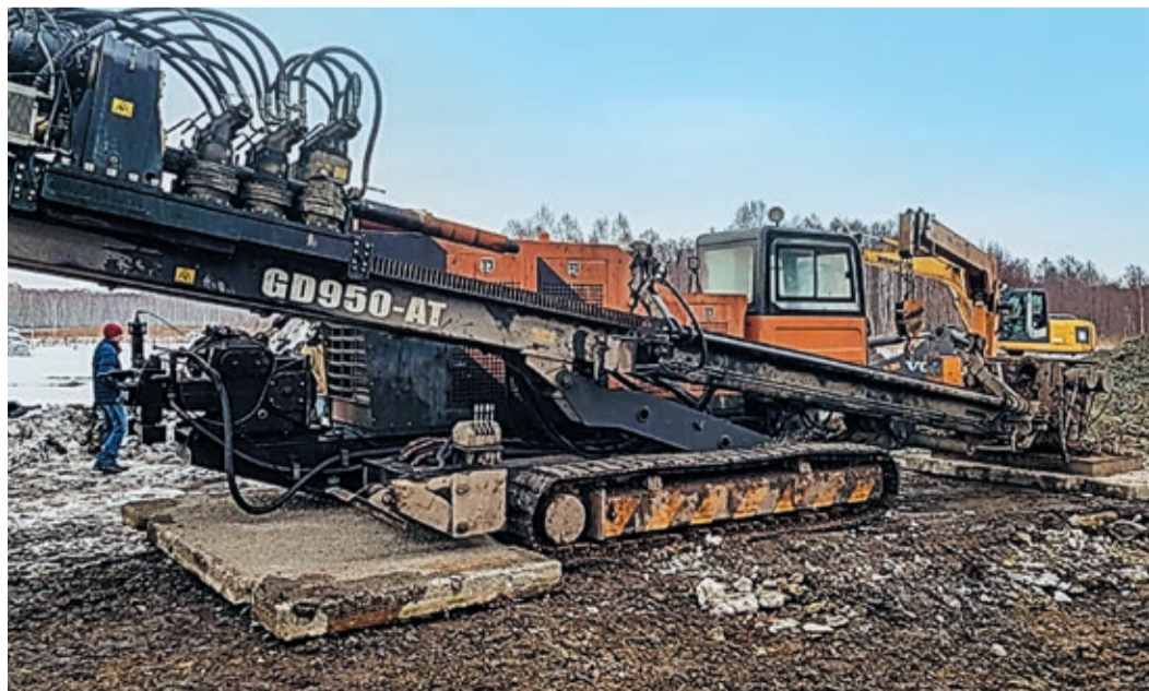
Установка GS900-LS пробурила горизонтальную скважину диаметром 1400 мм и протянула по ней 300-метровый дюкер
