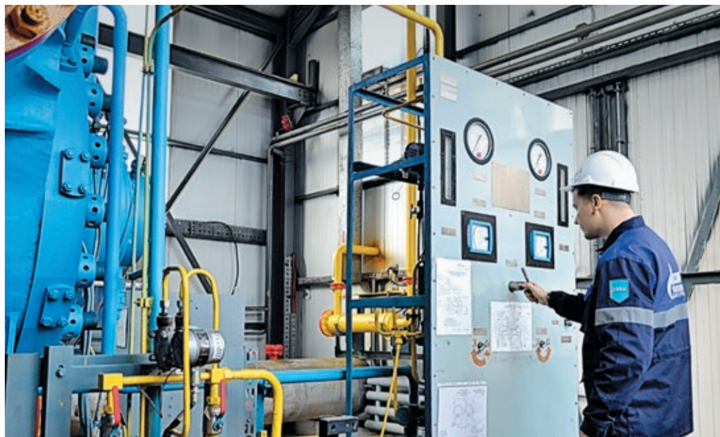
Во время комплекса ППР работники компрессорной «прозванивают» все элементы управляющей автоматики, от главного компьютера до отдельных проводов
