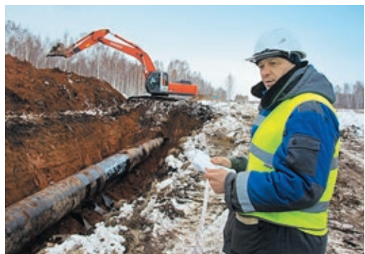
Из-за стресс-коррозии челябinceм пришлось менять протяженные участки газопровода
