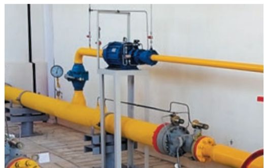
В 2019 году сразу три ГРС Красногорского ЛПУМГ оснастили турбодетандерными установками
