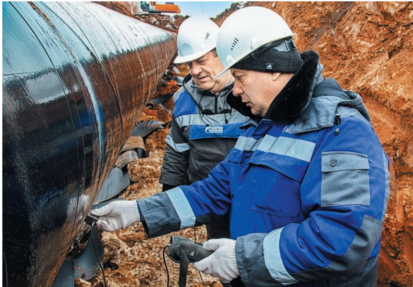
За два последних месяца специалисты Инженерно-технического центра обнаружили на участке МГ «Бухара – Урал» более ста труб, пораженных стресс-коррозией. Охоту на КРН ведут Илья Блинов (на переднем плане) и Николай Фомичев
