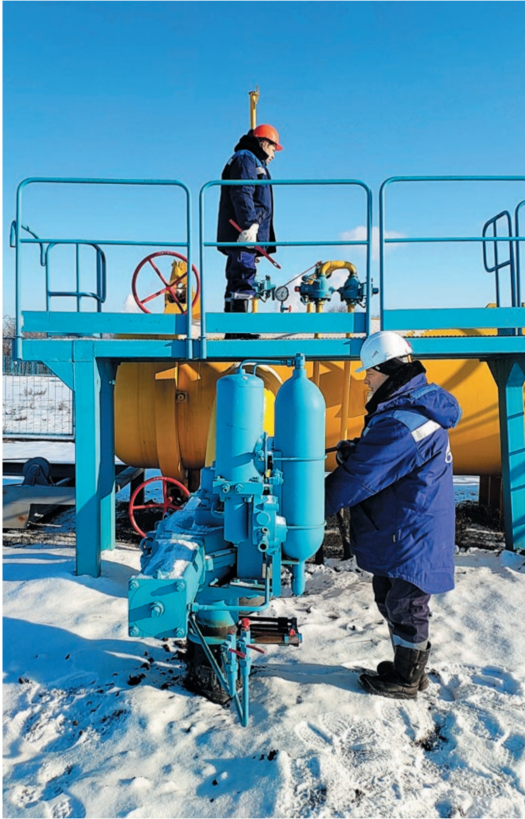
Камера запуска внутритрубных устройств газопровода «Союз» проверена и готова к работе
