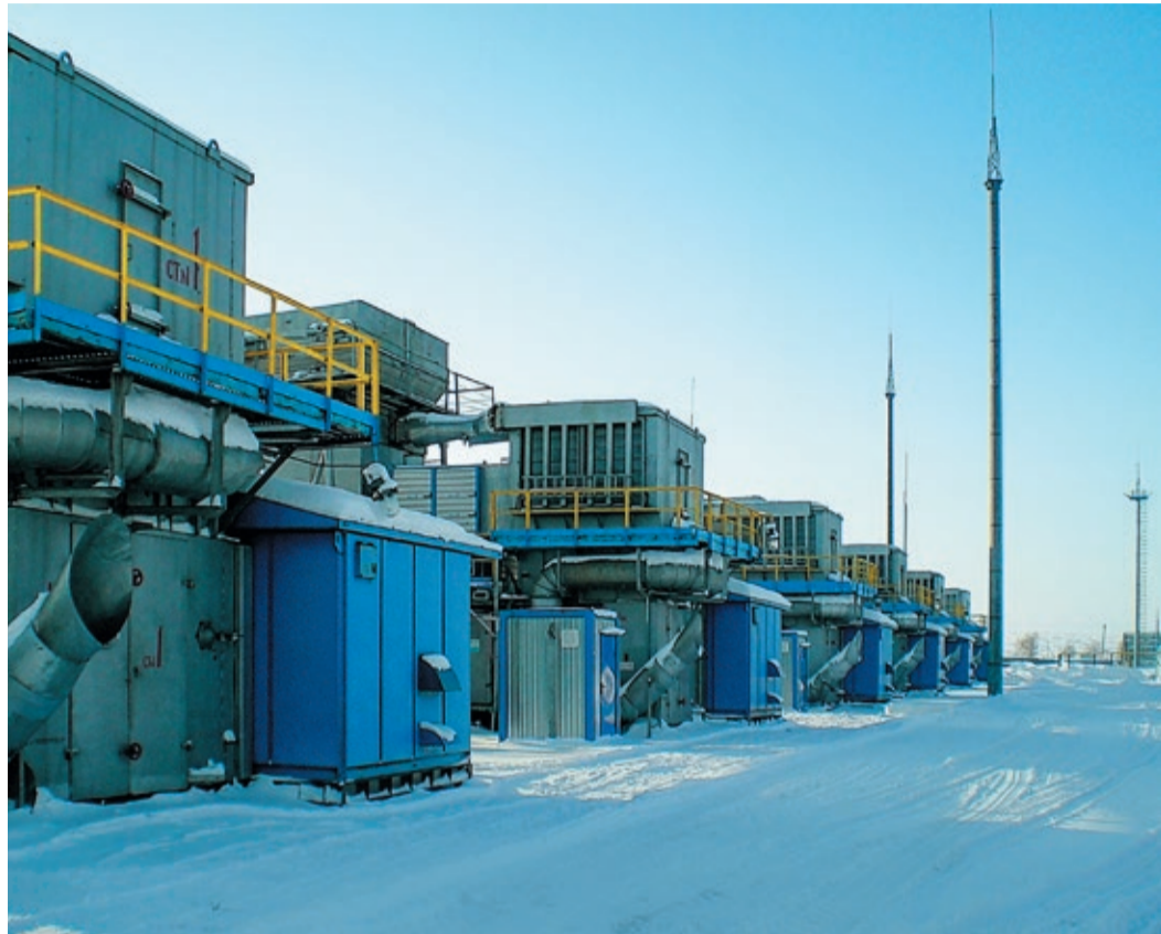
В перекачке дополнительных объемов газа участвовали три агрегата Саракташской ГКС
