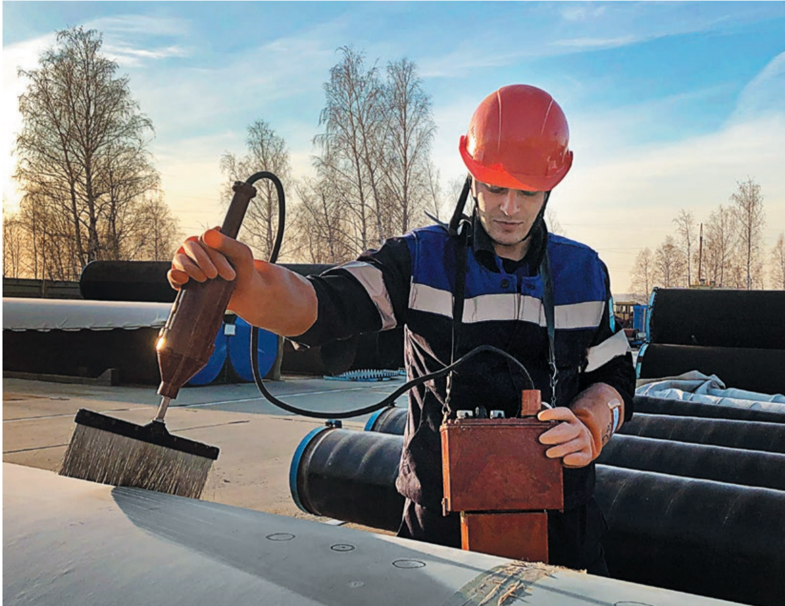
Склад аварийного запаса Челябинского ЛПУМГ: труба в эпоксидной изоляции смотрится пока «белой вороной» на фоне черного полиэтилена
