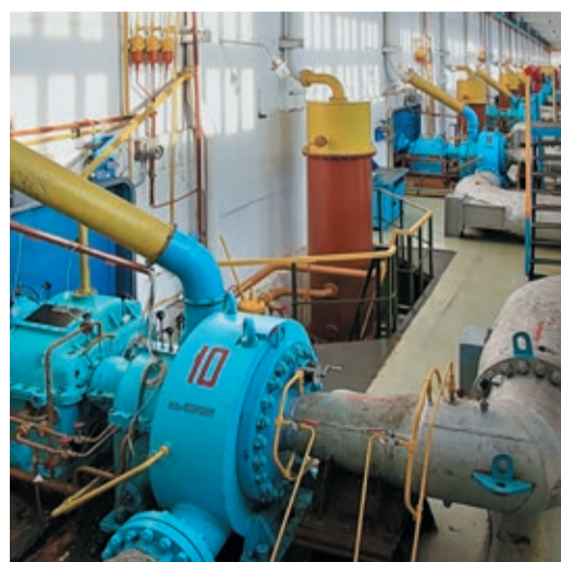
Надежность вентиляции нагнетательного зала КС-16 не вызывает сомнений
