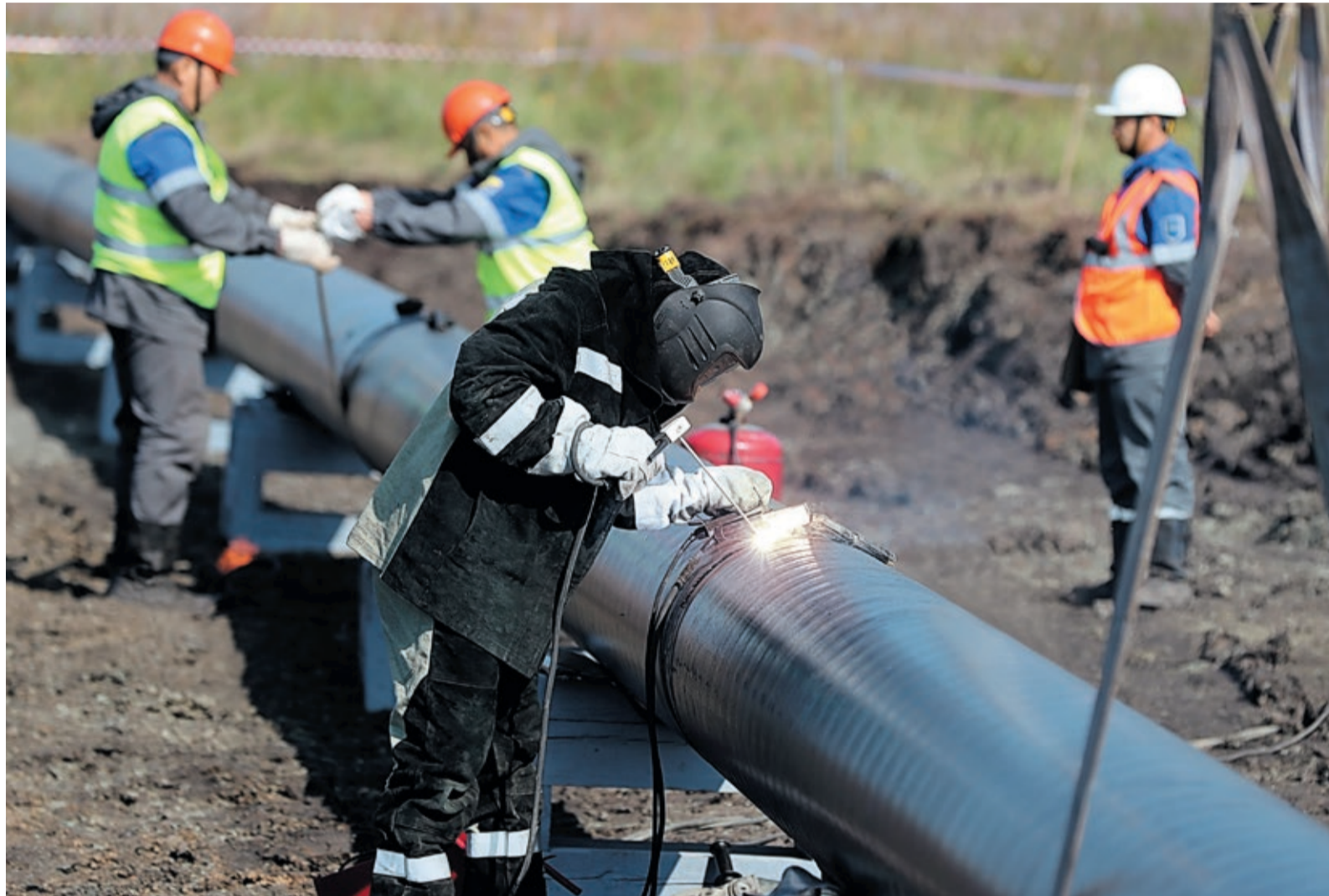
В конце августа Малоистокское ЛПУМГ и УАВР № 3 отремонтировали отвод к газораспределительной станции № 3, через которую газ получают нескольких районов Екатеринбурга и АГНКС, где заправляются муниципальные автобусы
