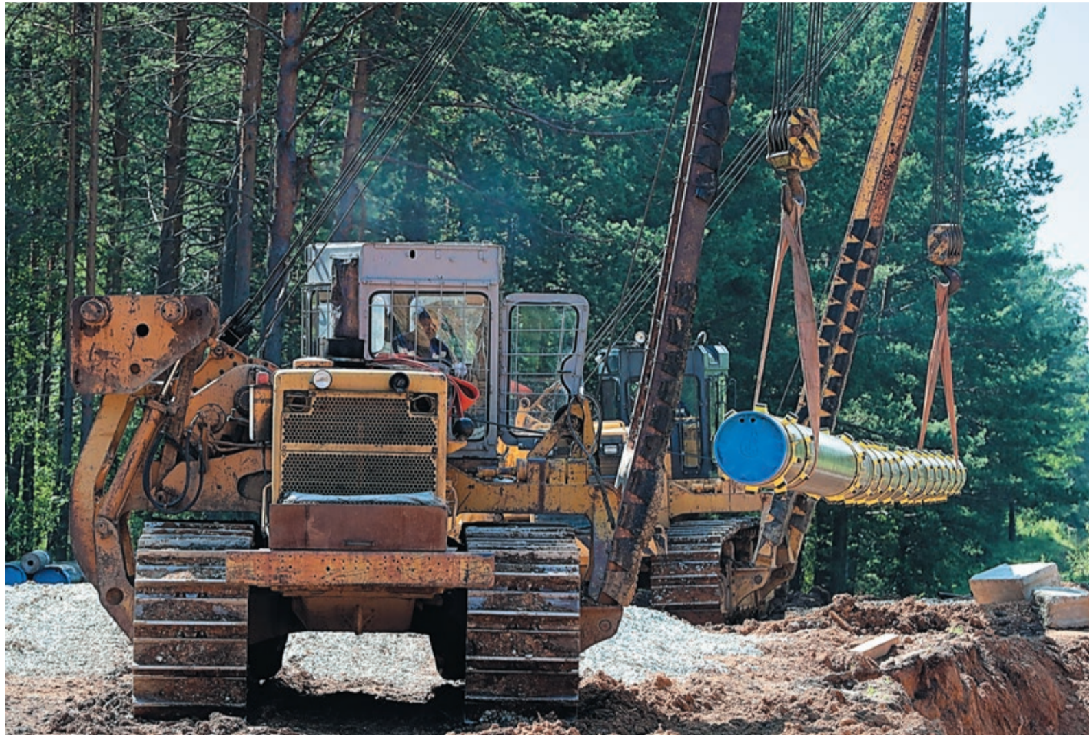
Точное попадание трубы в патрон обеспечили машинисты трубоукладчиков Вячеслав Исламгулов и Мавлизиан Зиннуров
