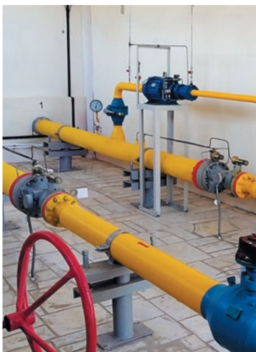
Турбодетандер установлен в узле редуцирования ГРС
