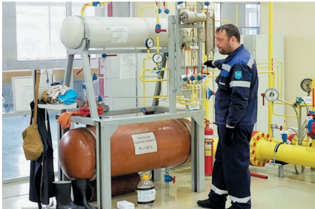
Первым делом операторы ГРС демонстрировали, как они умеют заполнять рабочую емкость одоризационной установки
