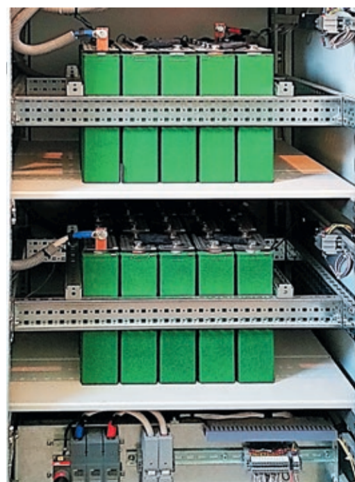
Впервые в истории нашего предприятия для энергоснабжения ГРС используются аккумуляторные батареи
