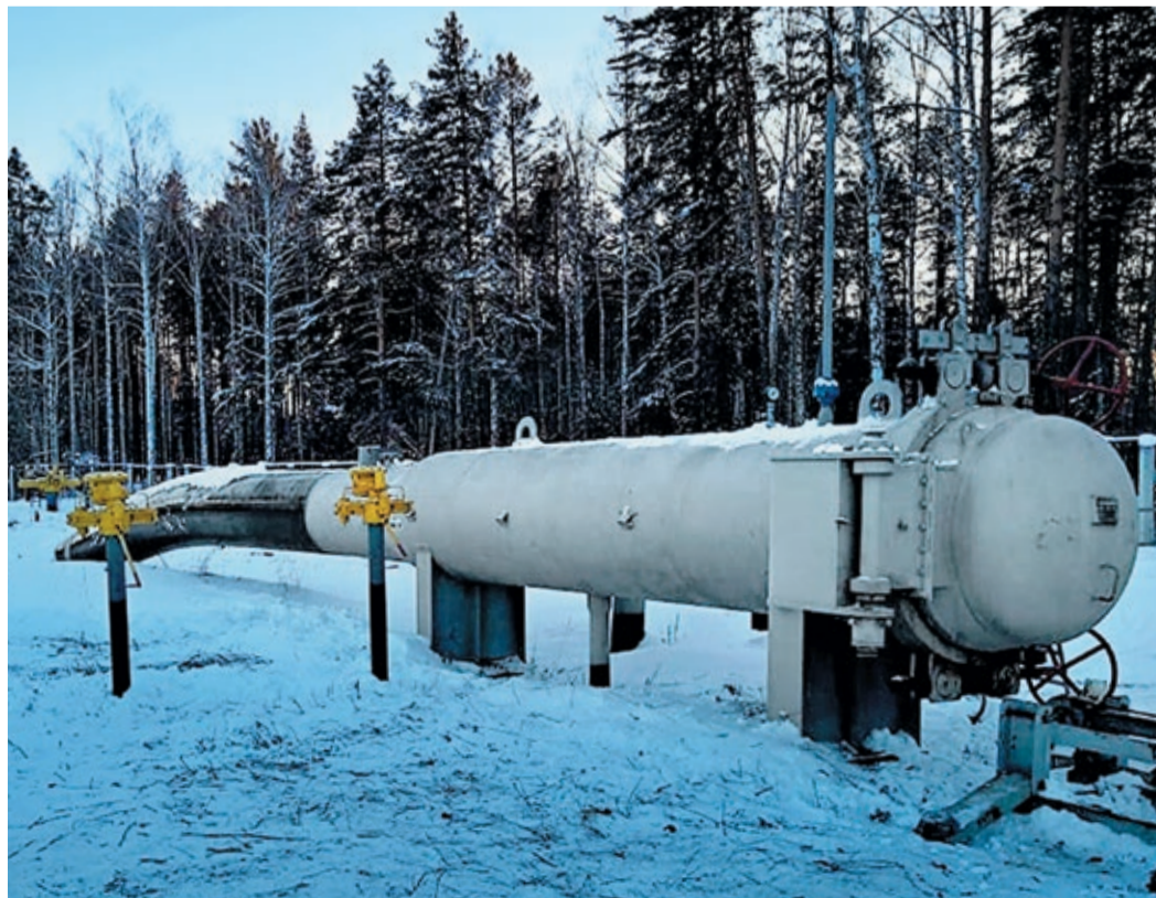
Стационарная камера приема на магистральном газопроводе диаметром 1000 мм
