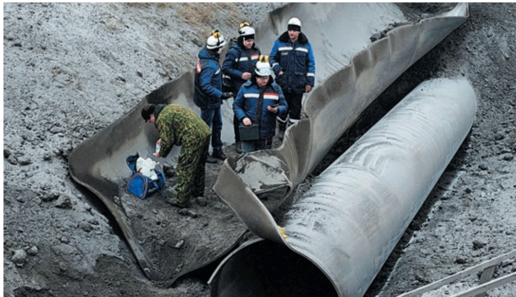
От взрыва катушка-инициатор «раскрылась» полностью, но трещина не прошла дальше первого сварного шва
