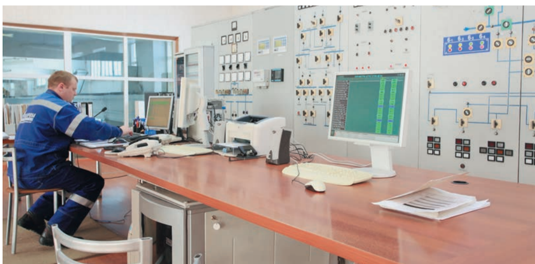
На самых заслуженных «бухарских» станциях газоперекачивающие агрегаты давно управляются с компьютера
