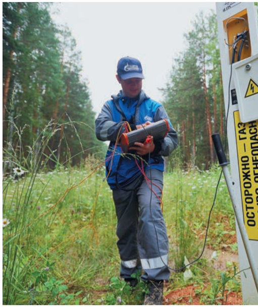
Замеры потенциалов позволяют оценить защищенность газопровода
