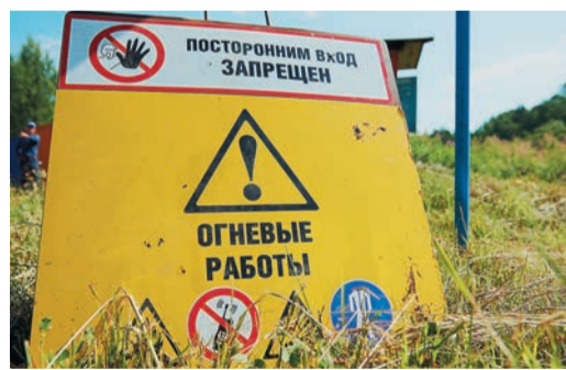
Первые ремонтные работы по результатам ВТД на газопроводе отводе к ГРС-4 могут пройти уже в этом году
