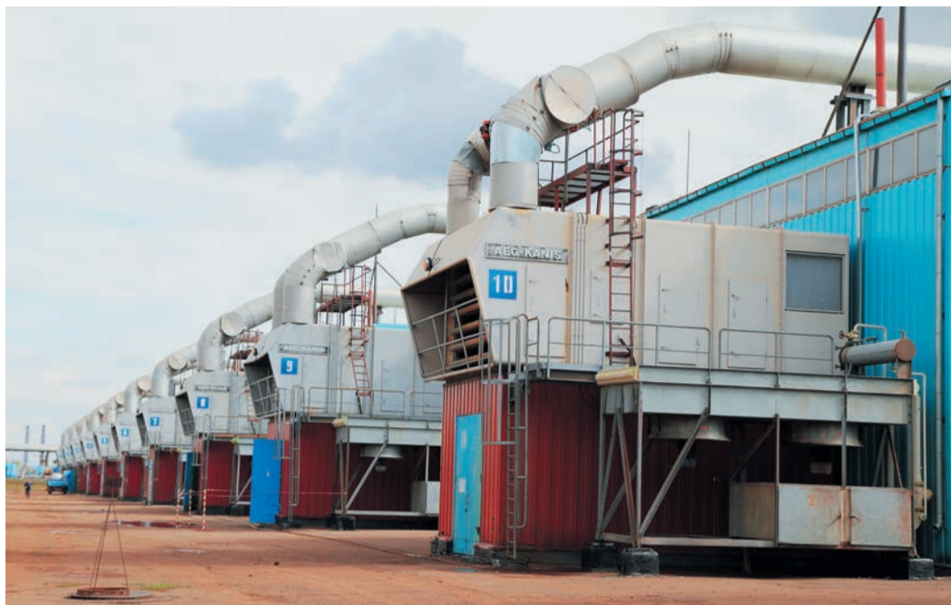
Подогрев масла на агрегатах цеха «Союз» больше не сбивает расчеты энергетиков филиала
