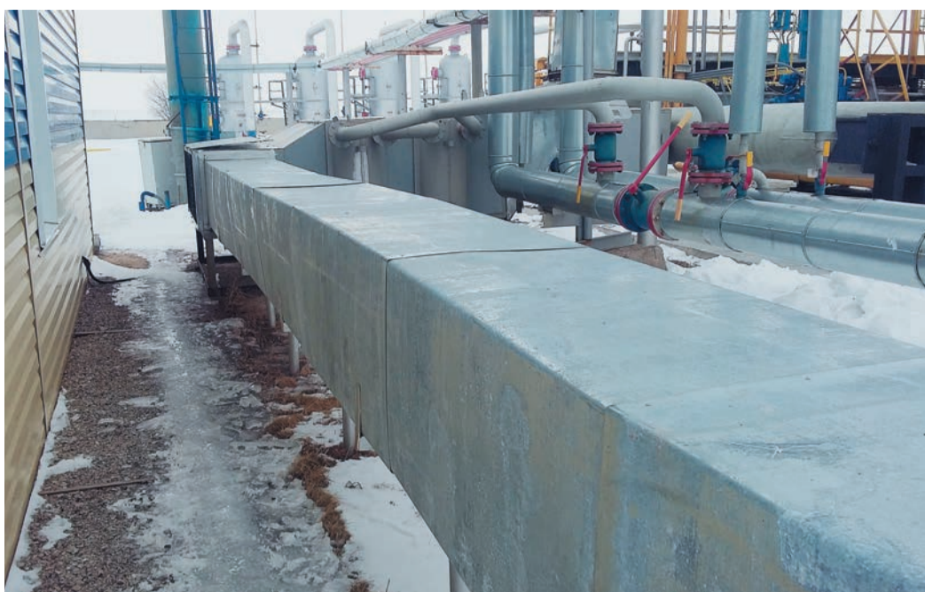
Воздух из подземного кабельного канала попадает в теплообменник по 15-метровому воздухопроводу
