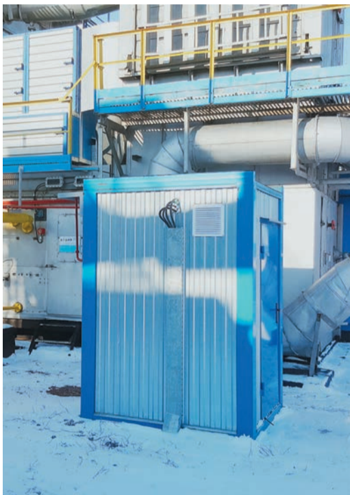
В ходе реконструкции на КС «Саракташская» полностью заменили систему автоматической сигнализации и контроля загазованности, а также установили новую пожарную сигнализацию и блоки автоматического пожаротушения в укрытиях ГПА
