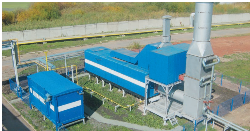
Испытания газотурбинной электростанции с дожимной компрессорной установкой начались в Копейске в 2015 году
