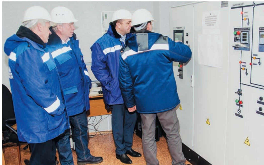
Приемочная комиссия положительно оценила возможность управления «Корветом» с главного щита завода
