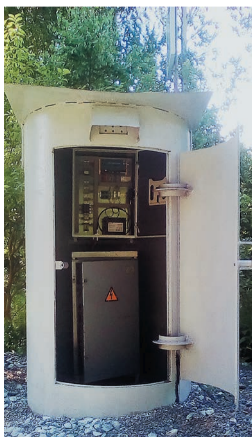
В укрытии над основным оборудованием размещают блок для сбора и передачи данных СТМ-3000
