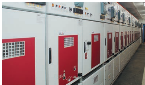
Для каждого вакуумного выключателя предусмотрена отдельная ячейка с блоком защиты
