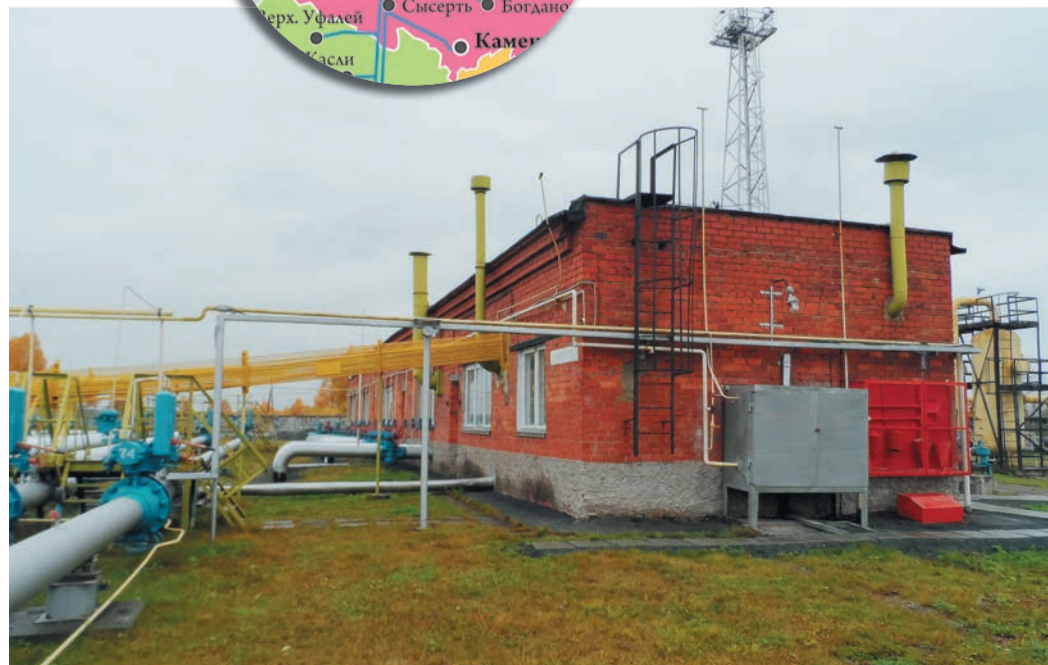
Ремонт по результатам экспертизы промбезопасности прошел на самой мощной ГРС в зоне ответственности невянских газовиков
