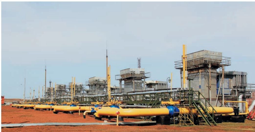
В ноябре компрессорная в Саракташе первой приняла газ из подземного хранилища, а теперь участвует в пополнении запасов
