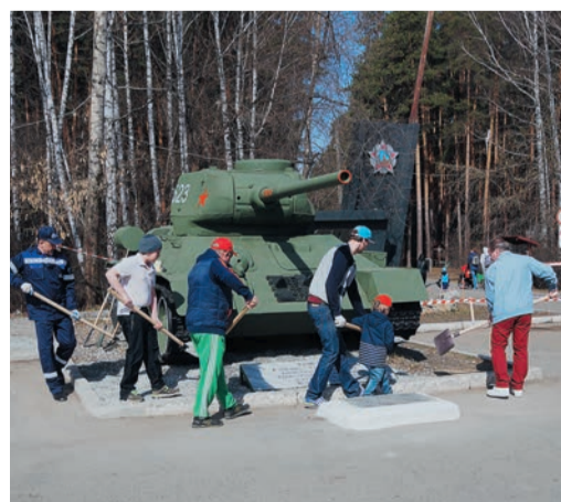
Газовики облагородили площадку, на которой стоит Т-34, заменили гранитную плитку с надписью: «В 1941–1945 гг. уральские заводы выпустили десятки тысяч таких грозных боевых машин» и плитку, под которой находится капсула времени
