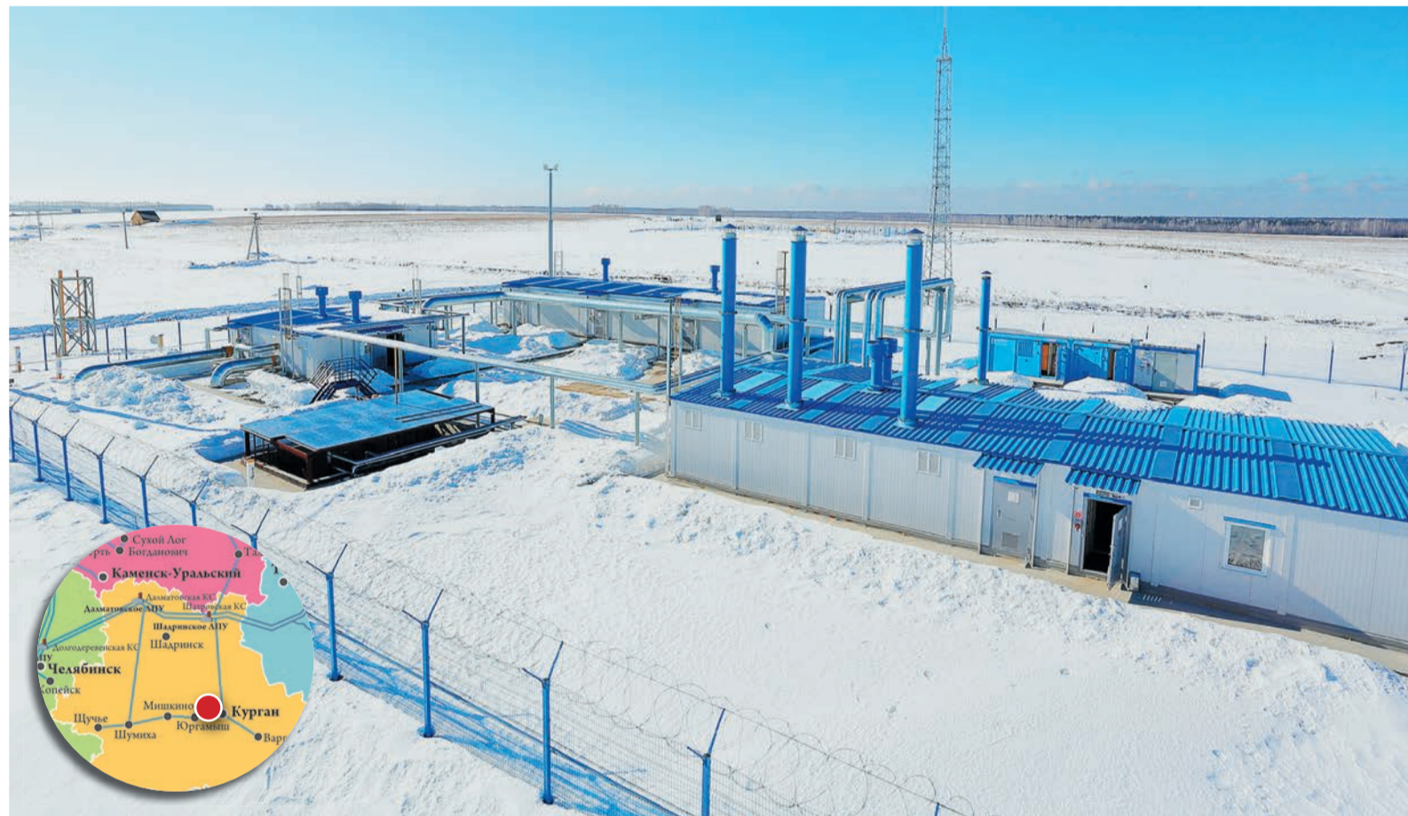
«Введенское» — пятнадцатая газораспределительная станция Шадринского ЛПУ
