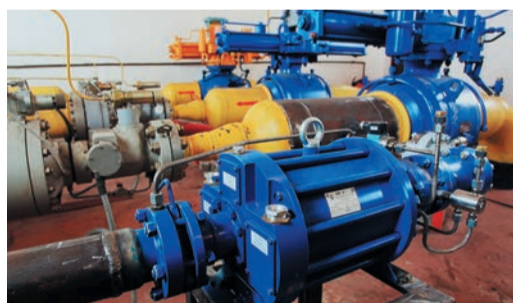
В ближайшие месяцы магнитогорцы рассчитывают получить первые киловатты электроэнергии, выработанные турбодетандером
