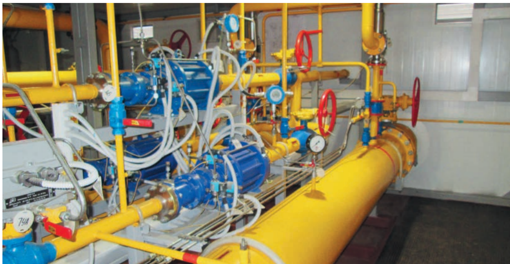
Первые серийные турбодетандеры установлены на ГРС Невьянска
