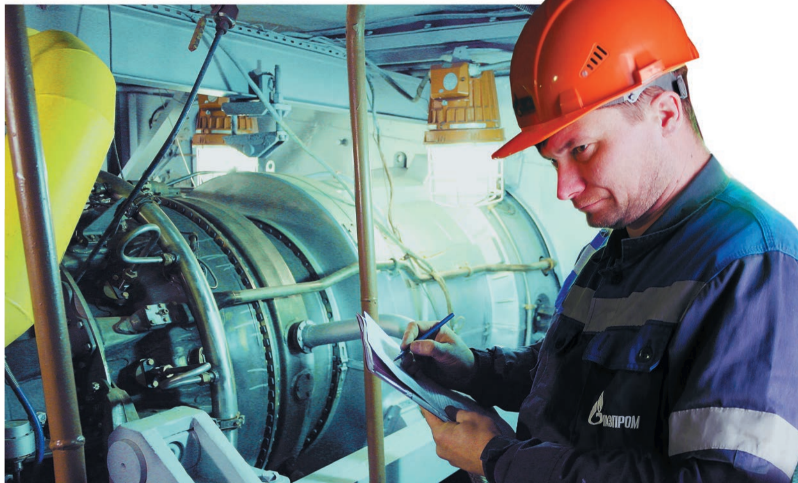
Машинист ТК Дмитрий Котляров проводит плановый обход турбоагрегатов: на Медногорской ГКС техника к реверсу газа готова
