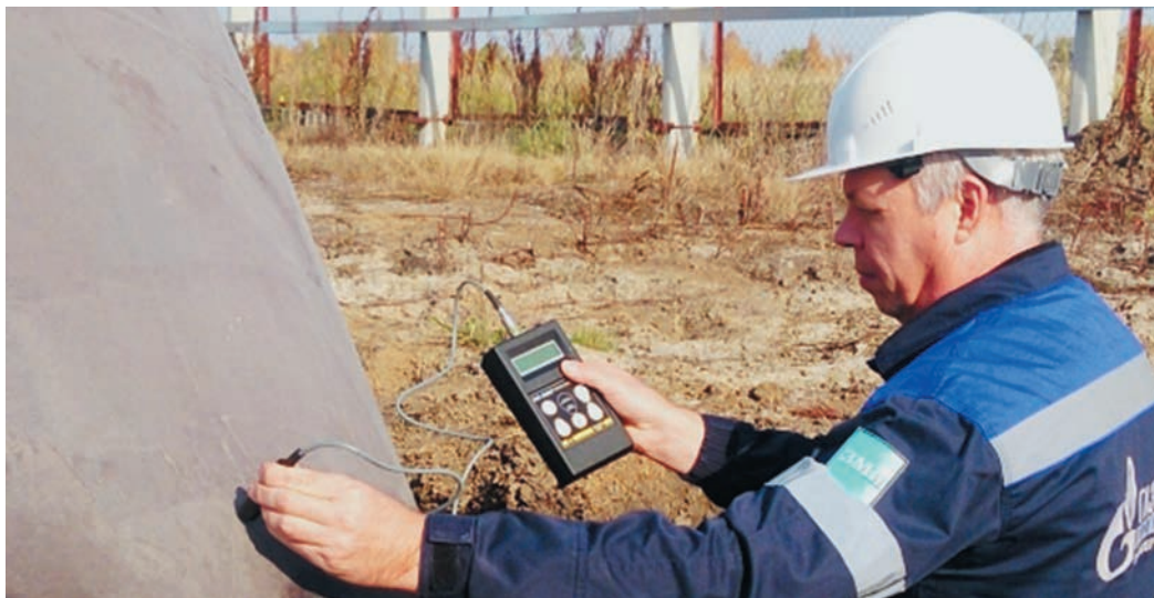
После визуального осмотра антикоррозионщики ИТЦ замерили толщину и диэлектрическую сплошность изоляционного покрытия
