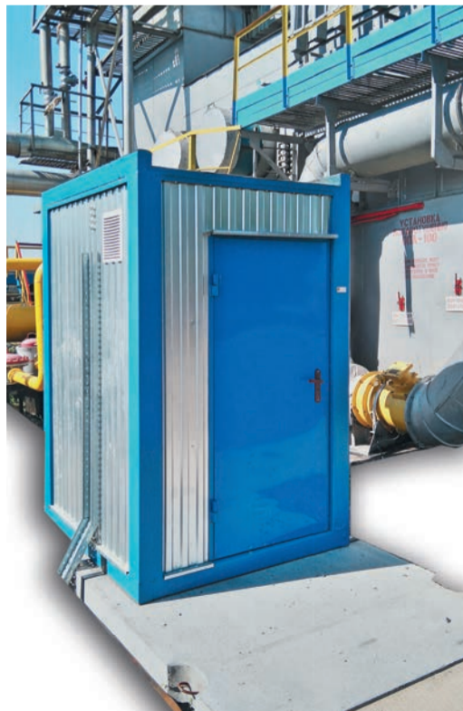
Рядом с укрытиями ГПА установлены новые блок-боксы автоматической системы пожаротушения
