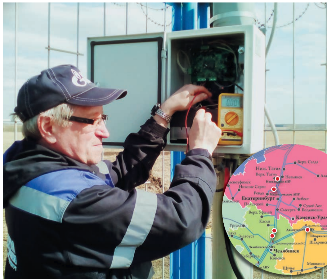
На трассе сейчас работает шесть солнечных батарей, обеспечивающих электричеством телемеханику крановых узлов
