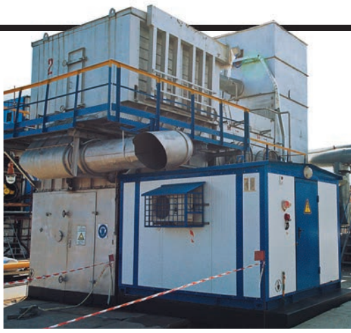
В центре внимания — реконструкция САУ на КС «Бурдыгино»
