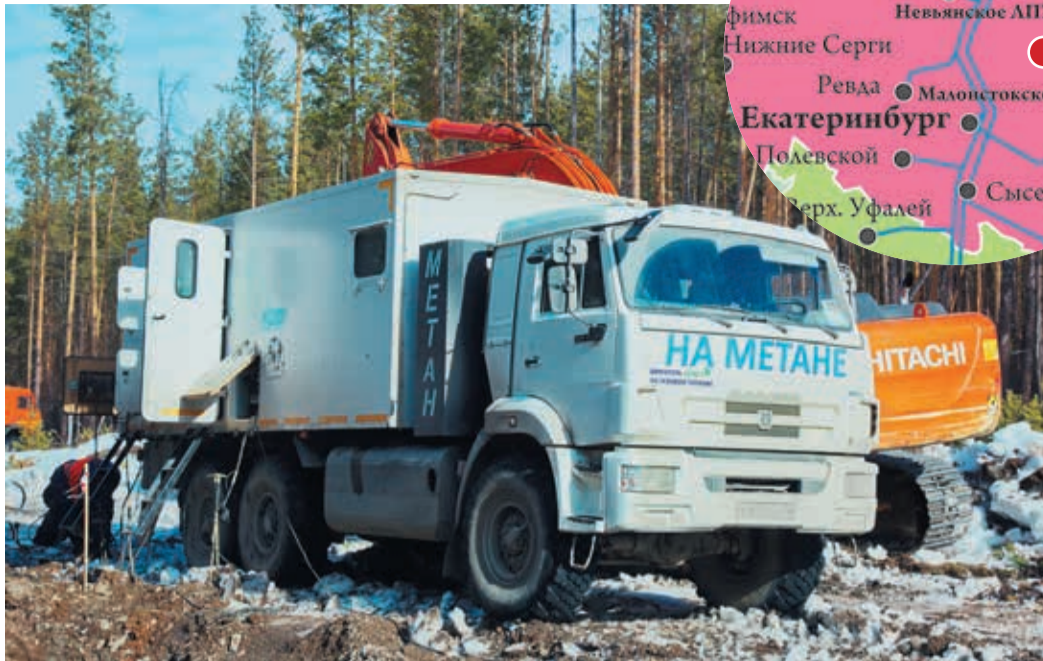
Энергетическую поддержку бригады осуществляет АРС на газомоторном шасси
