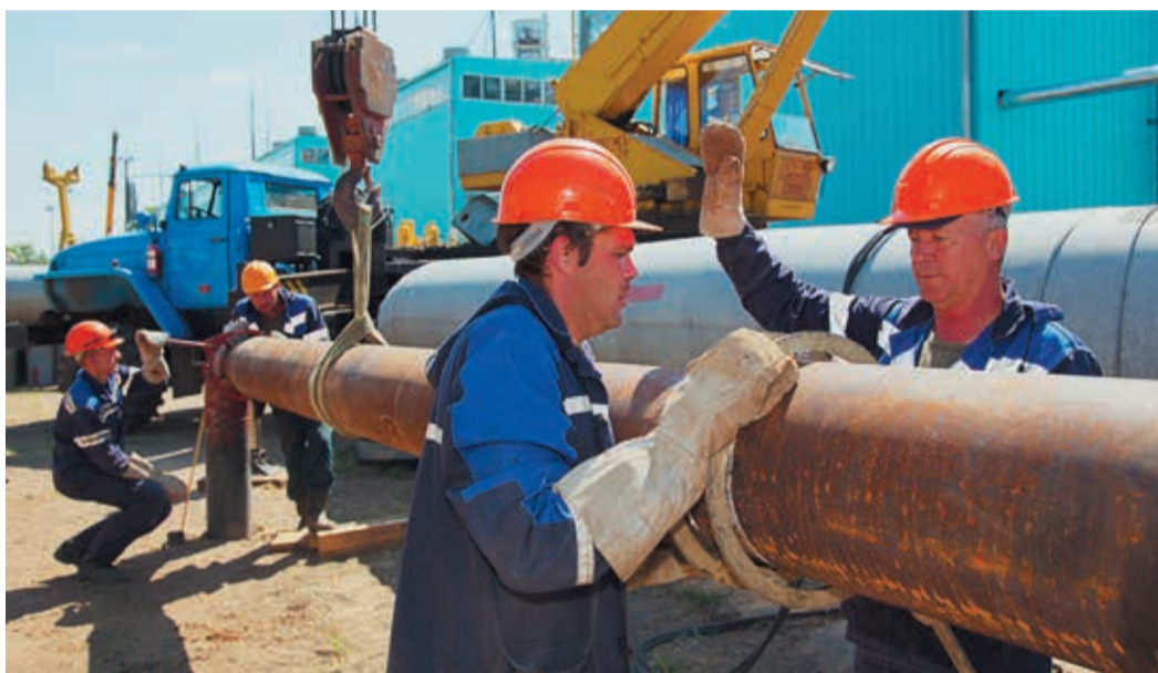
Монтаж 6-метровой катушки оказался самым тонким моментом всей операции на каждом ГПА
