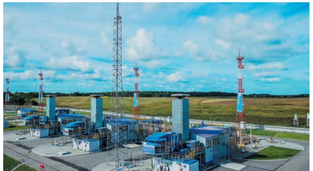
Калининградское подземное хранилище газа
