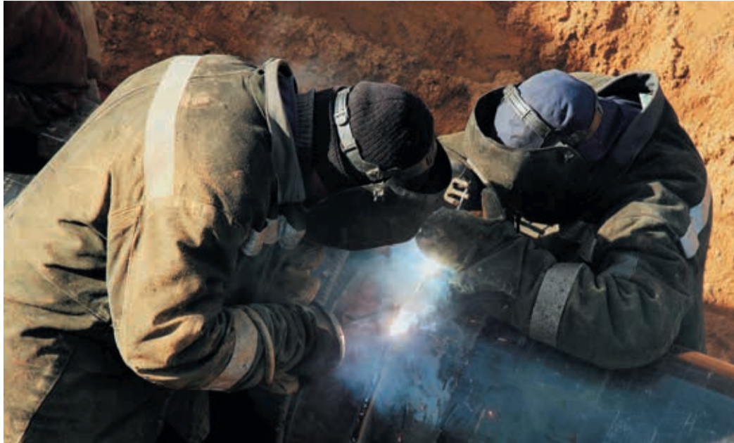
Георгий Лапатин и Юрий Чмишук ставят точку в сложной процедуре центровки гнутого отвода
